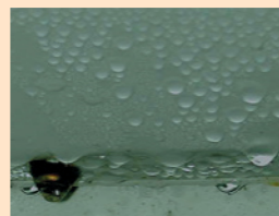
取り付け前結露の様子
