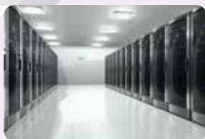
サーバールーム
